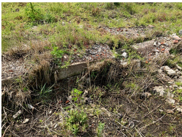
Foto 9 – puin op maaiveld
