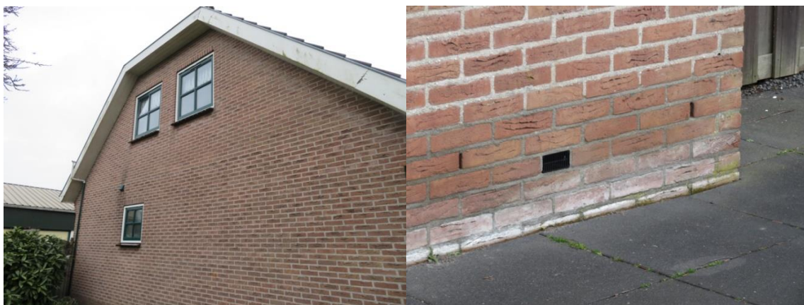
Afbeelding 11: Close-up foto's van gevel en open stootvoegen woning 5.
