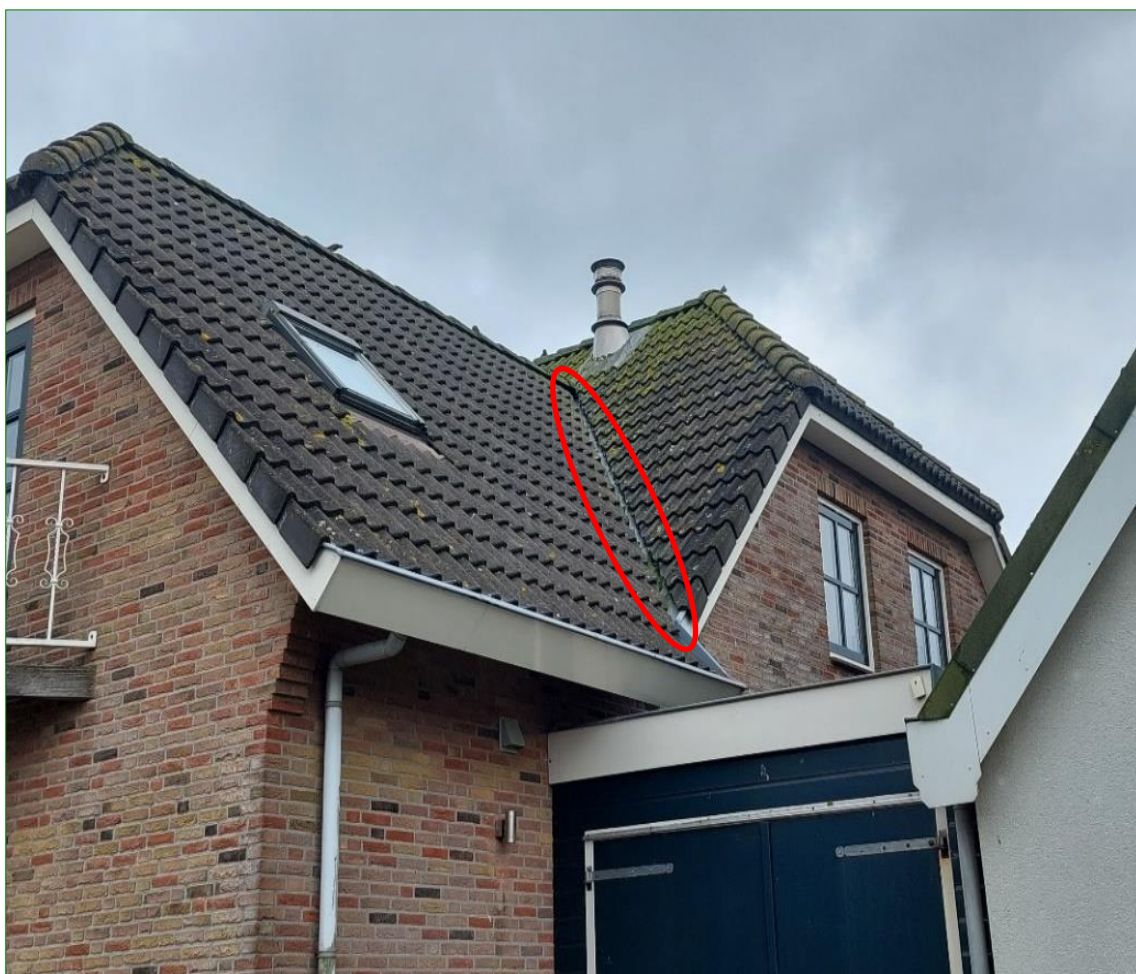
Baltsende Huismussen op het dak van het naastgelegen woonhuis (nummer 38). De nesten bevinden zich hoogstwaarschijnlijk onder de dakpannen onder de rode omlijning, gezien de holtes die hieronder aanwezig zijn
