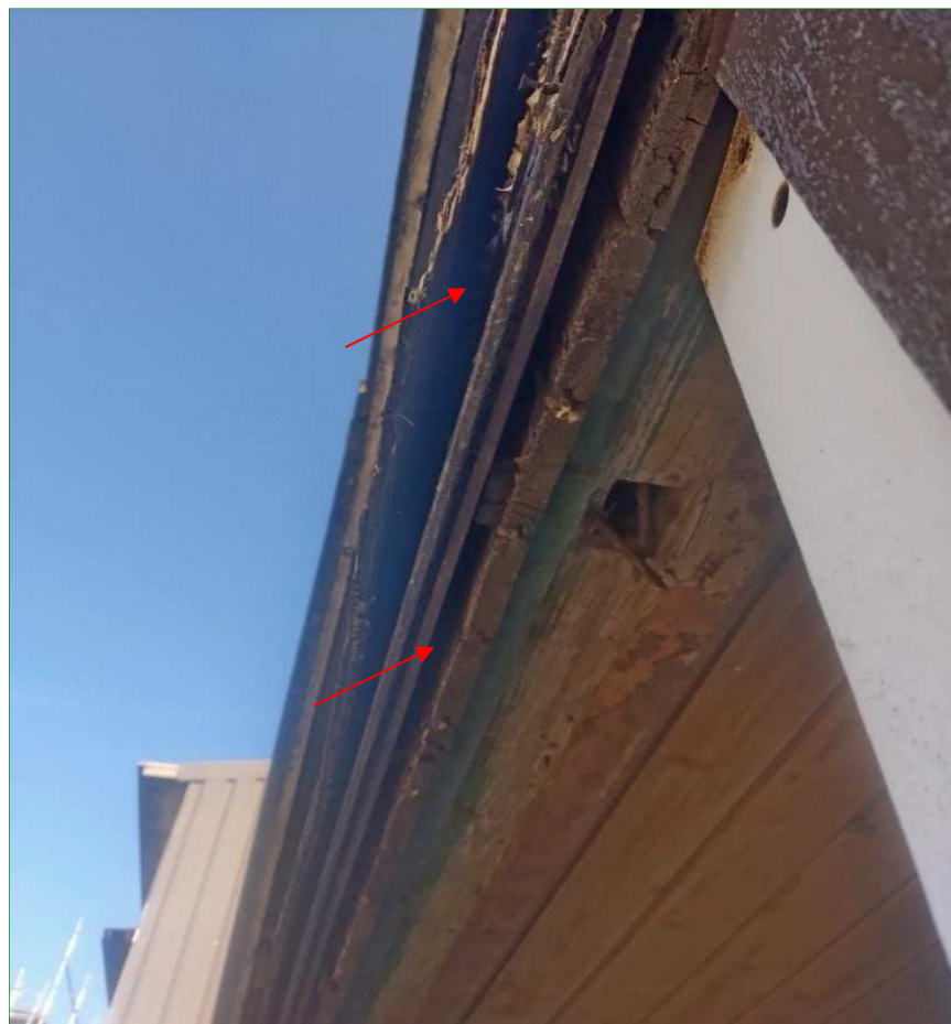
Spleten boven de deur van gebouw 3 geven toegang tot voor dwergvleermuizen geschikte holtes.
