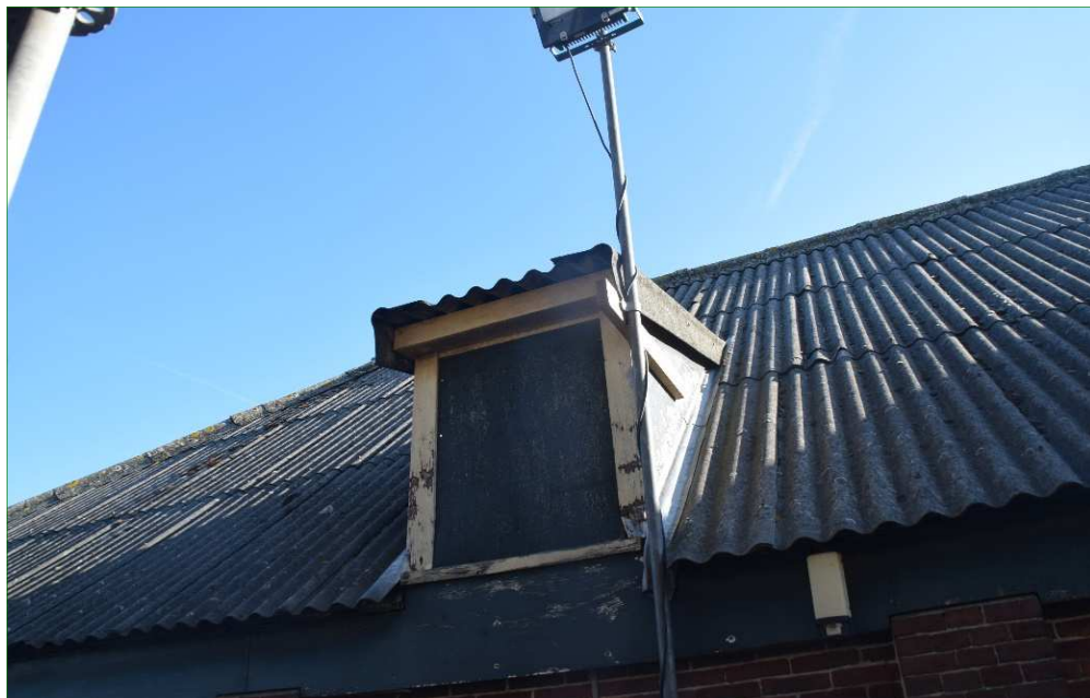
De openingen onder de golfplaten van gebouw 1 bieden potentiële nestplaatsen voor Huismus.
