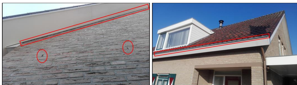
Figuur 1.3 In de woning zijn stootvoegen aanwezig. Daarbij is er een opening onder de overstek aanwezig. Van deze openingen kunnen vleermuizen gebruik maken. De onderste dakpannen zijn toegankelijk, waardoor de potentie voor nesten van huismus niet uitgesloten konden worden. (Jansen, 2018).
