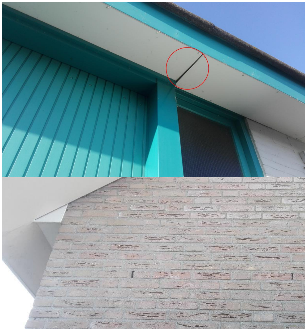
Figuur 2 De gebouwen op de planlocatie bevatten verschillende openingen en kieren die geschikt zijn voor vleermuizen.
