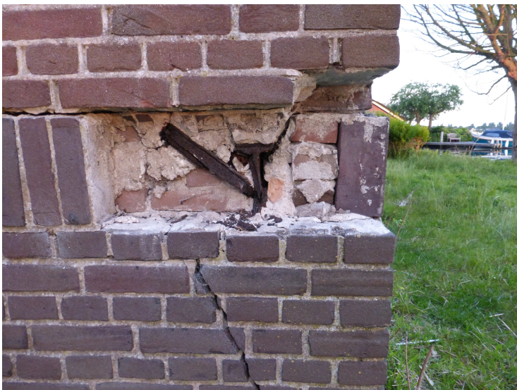
Figuur 2. Gat in de muur waarin de constructie van de steensmuur zichtbaar is.
