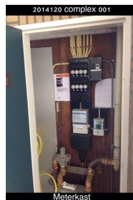
Foto 4: Meterkast, niet asbestverdacht.
