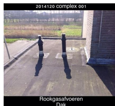
Foto 6: Rookgasafvoeren, geen asbestverdachte materialen.
