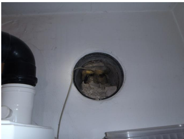
Foto 3: Rookgaskanaal, niet asbestverdacht.
