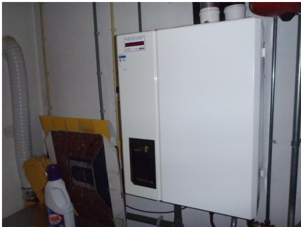
Foto 1: Ketels, Nefit HR, niet asbestverdacht.
