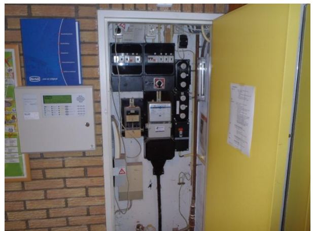
Foto 4: Meterkast, niet asbestverdacht.
