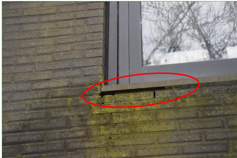
Een mogelijke gleuf onder het raamkozijn aangegeven met een rood ovaal.
