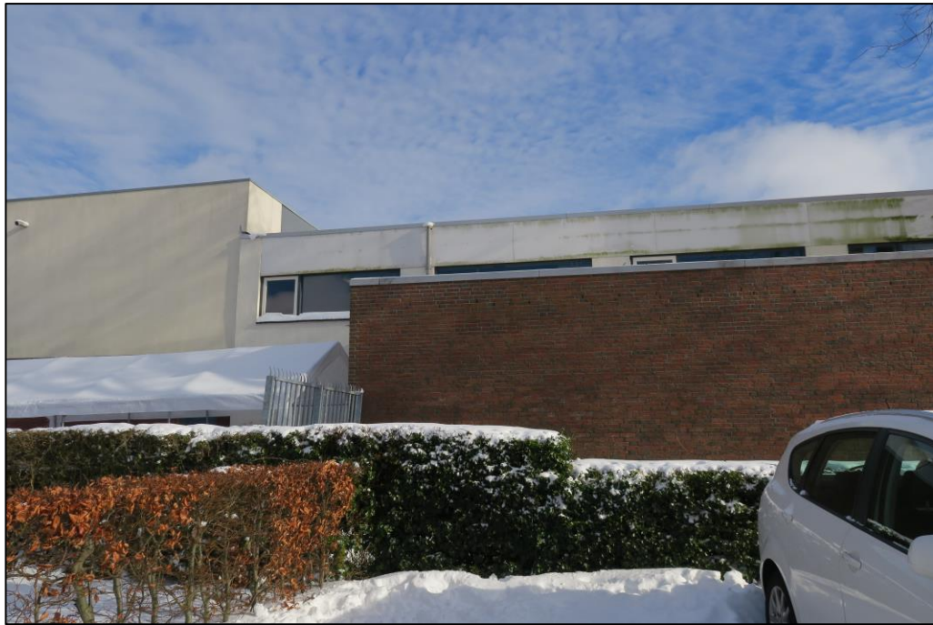
Figuur 5 Het schoolgebouw met gymzaal open stootvoegen en kierende daklijsten.
