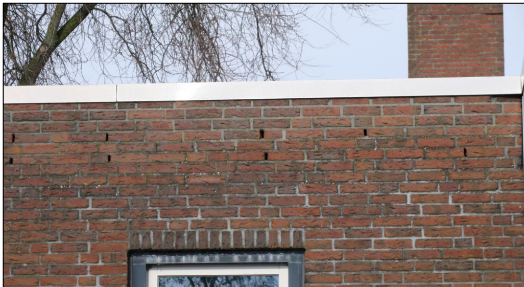
Figuur 3 In de gehele bebouwing zijn open stootvoegen aanwezig welke mogelijk leiden tot een geschikte rust- en verblijfplaats.
