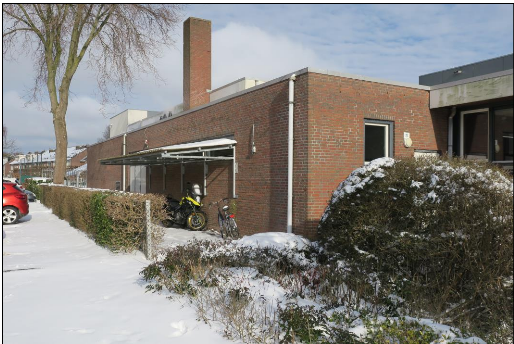
Figuur 4 Het schoolgebouw met open stootvoegen en kierende daklijsten, met daaromheen plantsoen.
