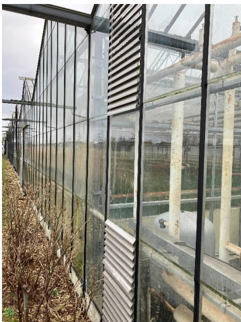
Afbeelding 2 Roosters in de oostelijke ketelruimte
