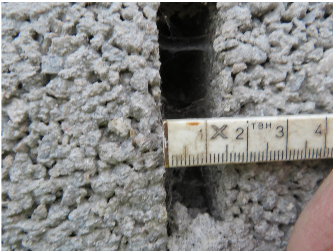
Afbeelding 5: Open stootvoeg van 1,4 cm met spinrag en cementresten. Dit was één van de bredere open stootvoegen.
