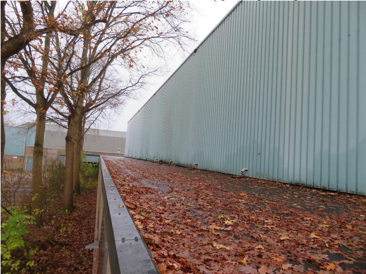
Damwandbeplating 2 e verdieping zwembad. Ook hier zijn geen openingen aanwezig.
