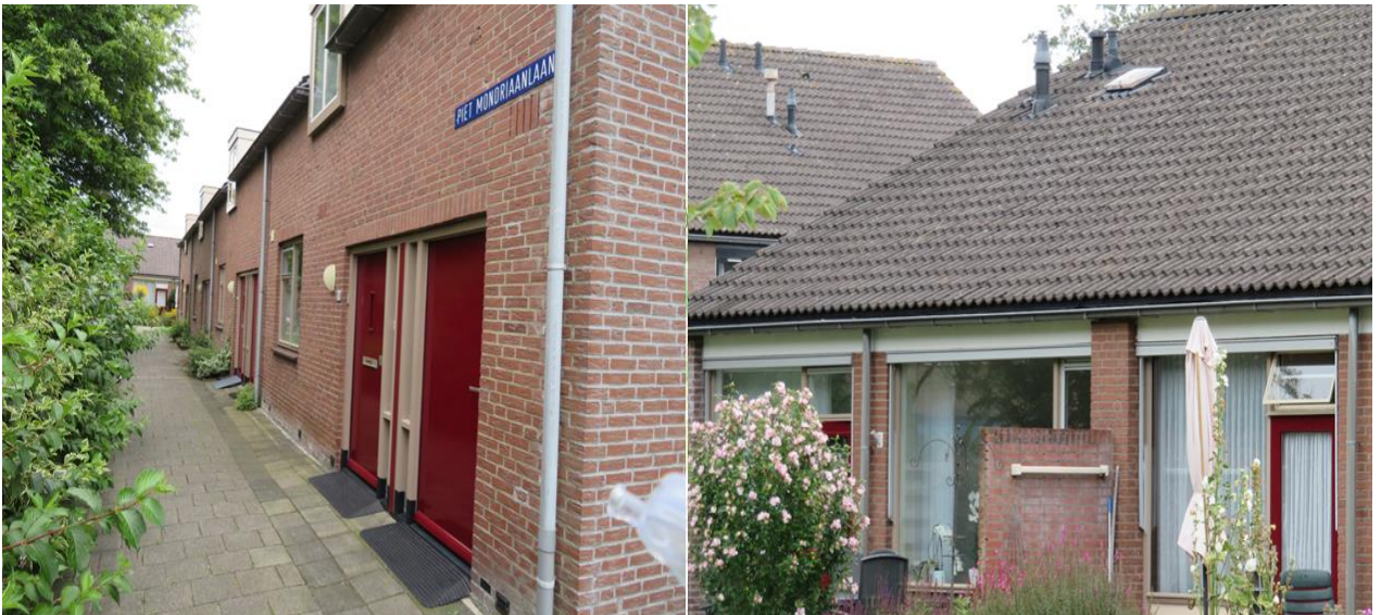
Piet Mondriaanlaan 13-19. Tussen de goot en dakpannen is geen ruimte voor huismussen aanwezig.
