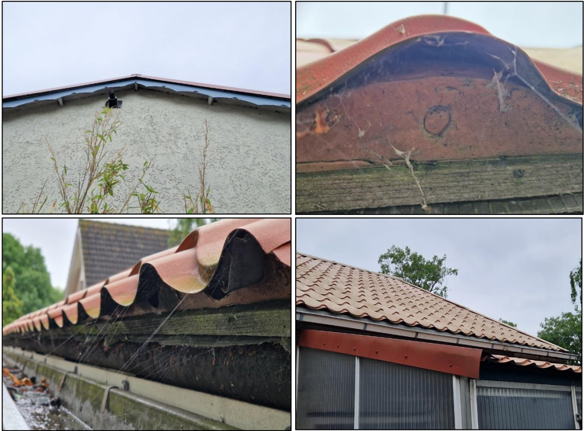
Figuur 3 Langs de volledig dakvoet is vogelschroot aanwezig. Aan de verwerking van het hout te zien is deze al enige tijd aanwezig. Er is tevens veel spinrag te zien langs de dakgoot, hierdoor kan worden afgeleid dat de dakvoet niet recent bezocht is door vogels. Langs de kopgevel zijn tevens geen opening aanwezig.
