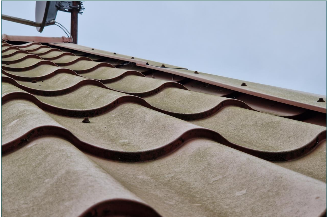
Figuur 3 Golflaten dak is vastgemaakt aan de dakbalken. Er is geen ruimte tussen de golflaten en de daklijsten.
