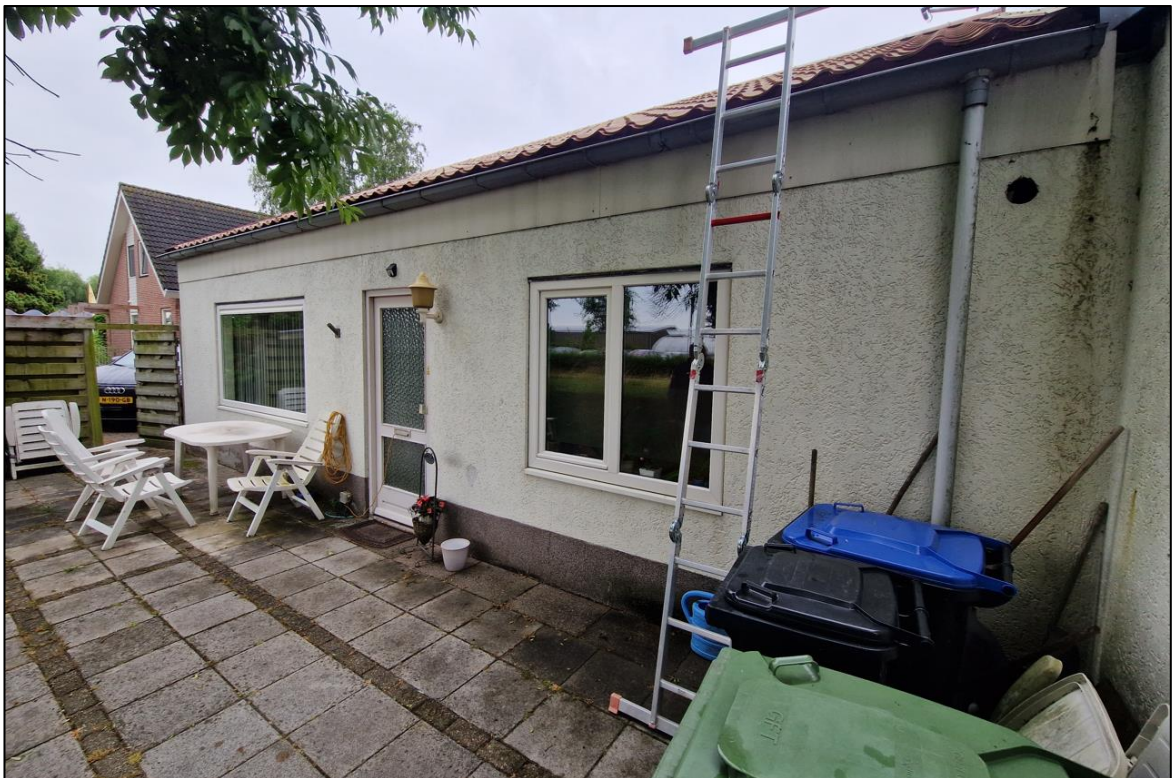
Figuur 2 Langs de volledige dakvoet is (geruime tijd) vogelschroot aanwezig. Verder zijn er geen geschikte openingen aanwezig voor huismussen.
