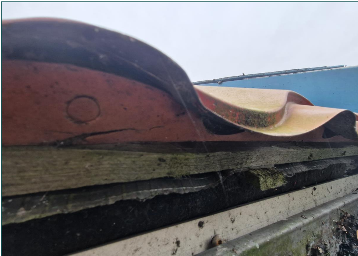
Figuur 4 Door de aanwezigheid van vogelschroot en het ontoegankelijke dakbeschoot. Is het voorkomen van huismusnesten niet mogelijk.
