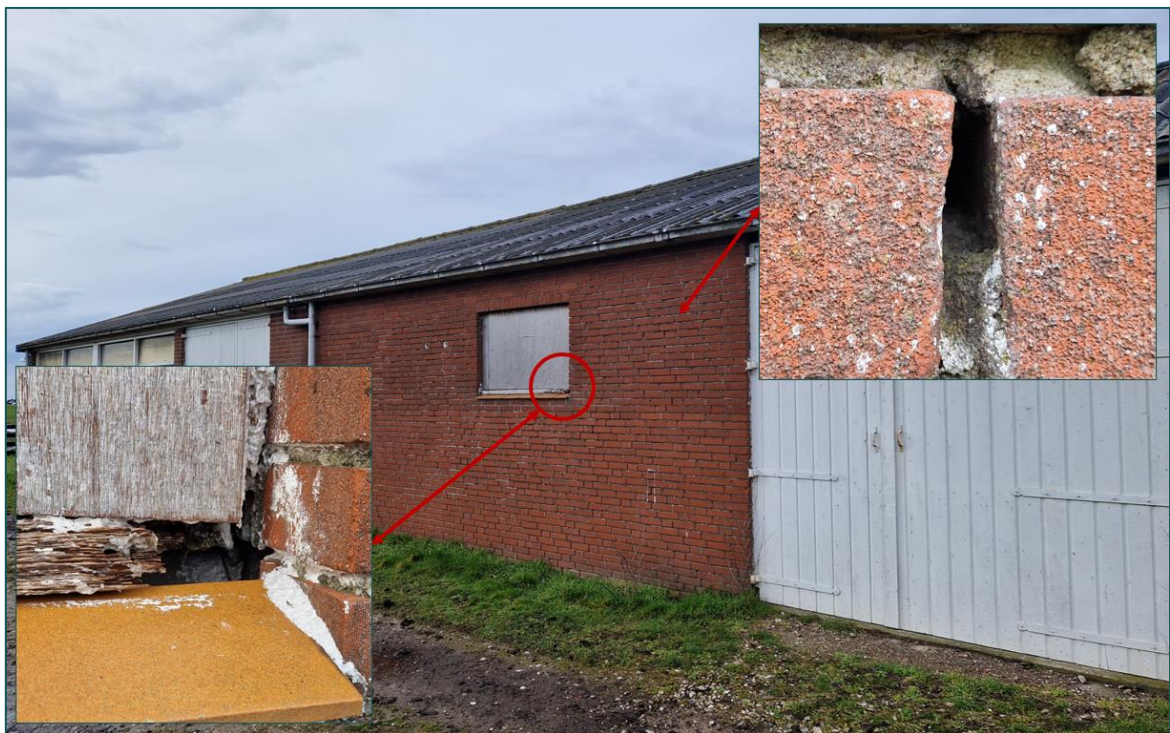
Figuur 3.1 Openingen welke toegang bieden tot de luchtspouw. Op veel plaatsen is de specie volledig verdwenen tussen de stenen.
