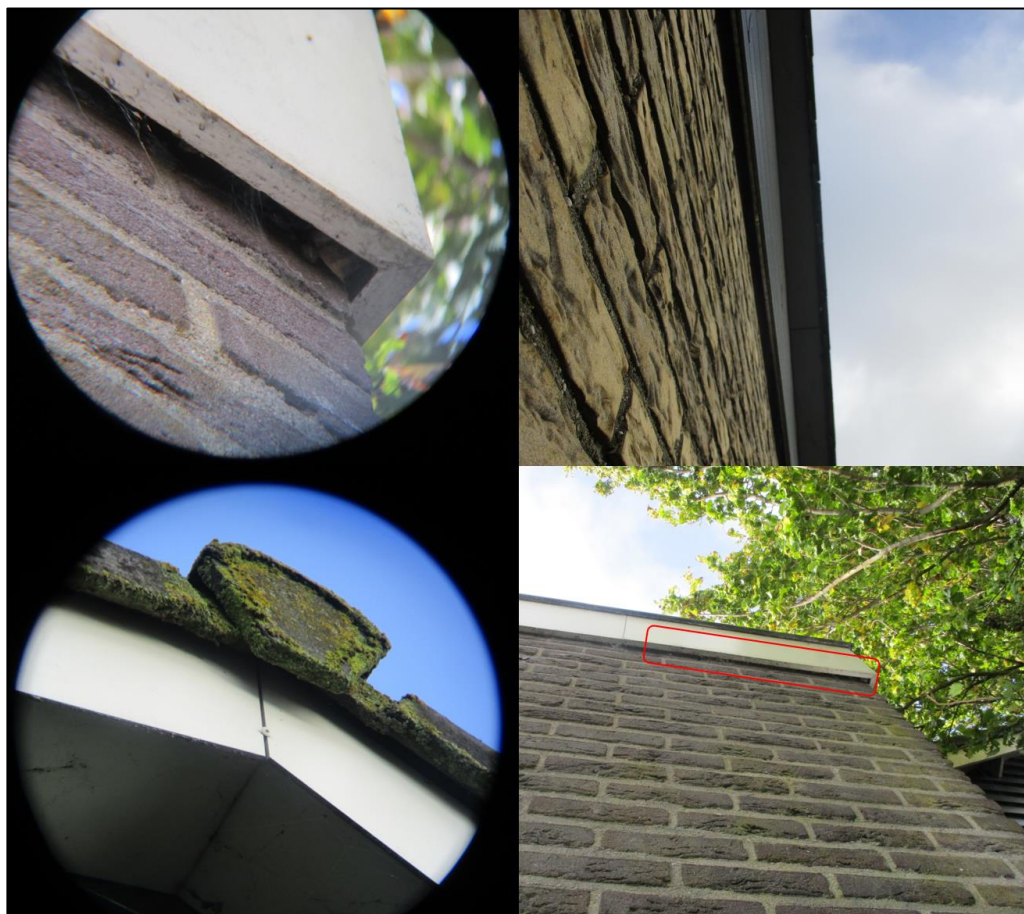
Figuur 1.3 Kierende kantpannen, nokpannen, boeiboord en kierende potdeksels zijn mogelijk geschikte in- en uitvliegopeningen welke leiden naar de spouw en/of open(kruip) ruimte.
