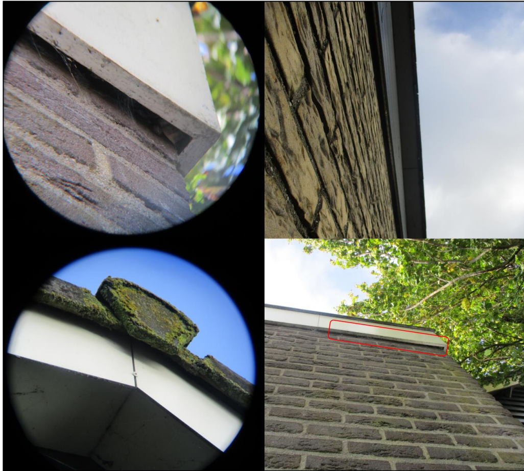
Figuur 3 Kierende kantpannen, nokpannen, boeiboord en kierende potdeksels zijn mogelijk geschikte in- en uitvliegopeningen welke leiden naar de spouw en/of open(kruip) ruimte.
