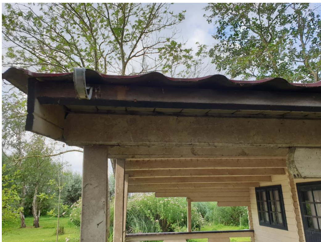
Figuur 2 De blokhut met een metalen dak direct op houten balken, waardoor er geen openruimtes zijn.
