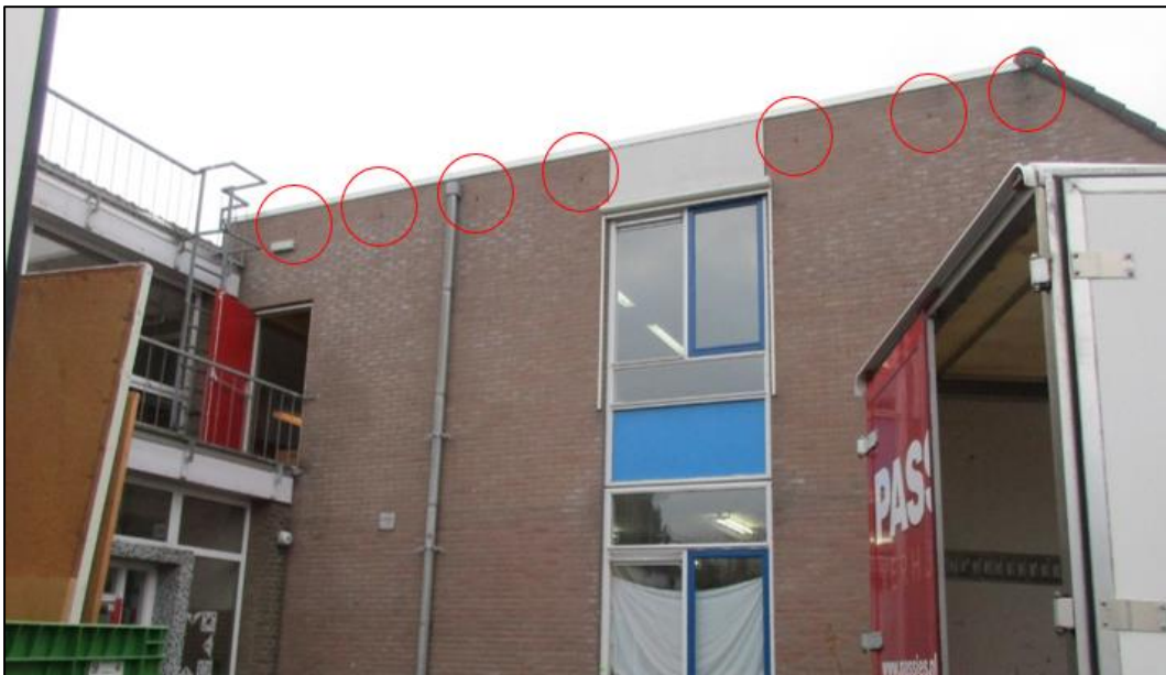
Foto 7: Open stootvoegen (rood omcirkeld) in het schoolgebouw
