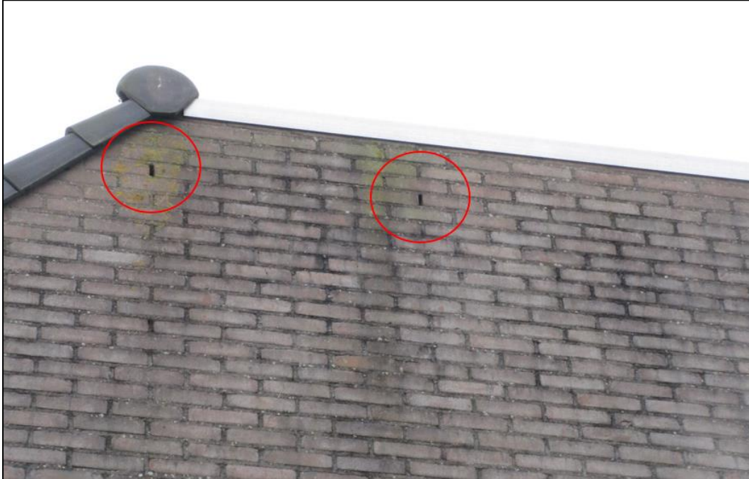
Foto 6: Open stootvoegen (rood omcirkeld) in pand van het schoolgebouw
