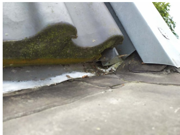
Figuur 10 Dakpannen zonder uitvalmogelijkheden
