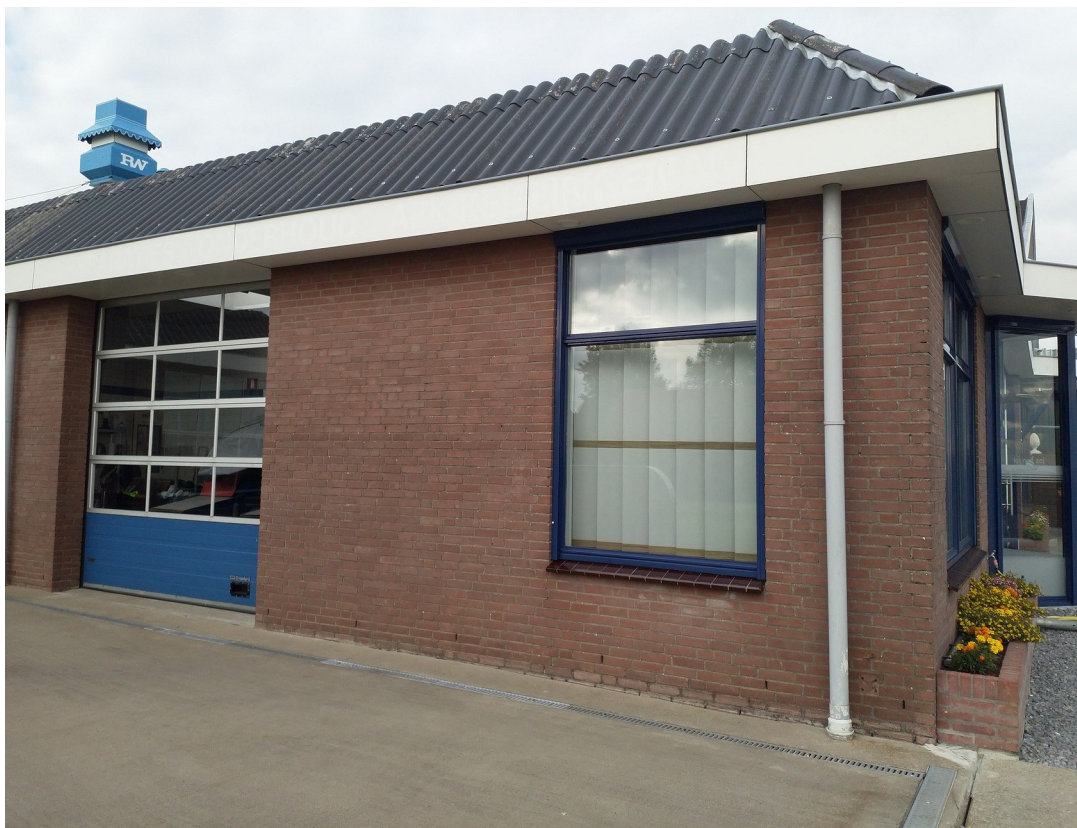
Afbeelding 11: Open stootvoegen aanwezig laag in de bebouwing, welke ongeschikt zijn als invliegopeningen voor vleermuizen. Foto: M.S. de Haan | Ecoresult B.V.
