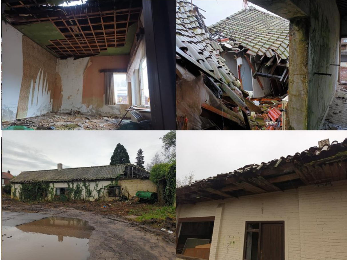
Figuur 6, foto's genomen van het dak van de woning. Boven links zie je de regen binnen vallen.
