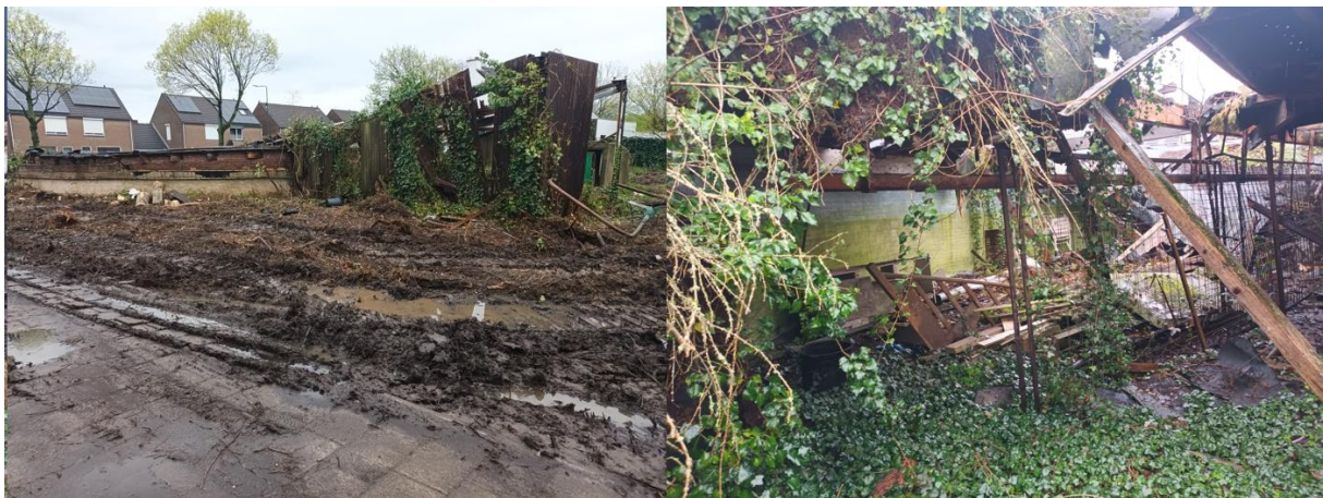
Figuur 7, ruim de helft van het ronde gebouw in de tuin is ingestort en vrijwel open.
