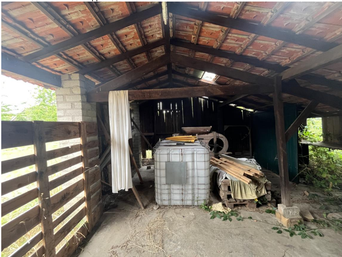
Foto 4: Dakconstructie en staat van de oude kippenstal
