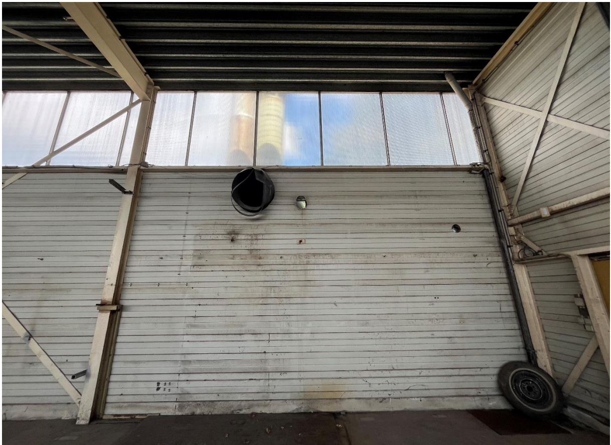
Foto 3: De gaten, welke naar buiten leiden, in de noordgevel van het bedrijfspand.
