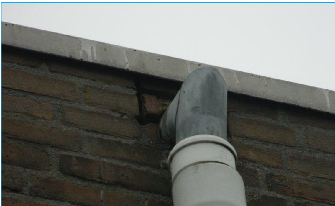
Foto: Vermeende opening bij regenpijp is niet geschikt voor vleermuizen, biedt geen doorgang naar spouw of dak.
