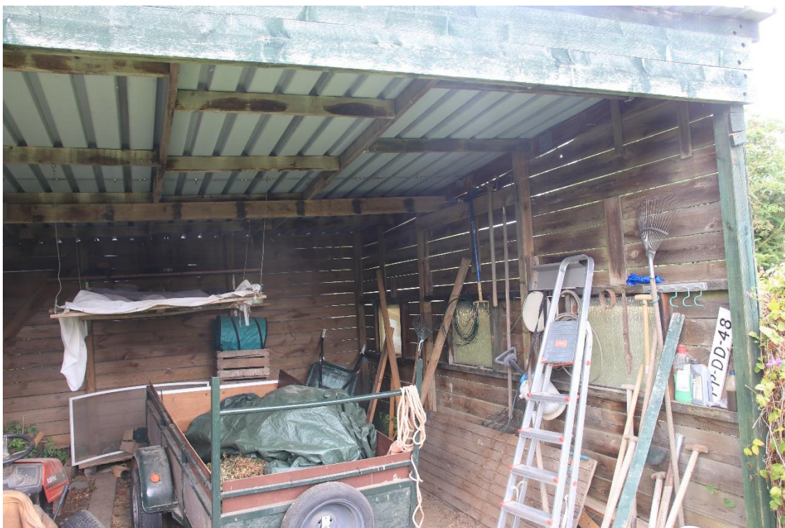
Foto 4: de schuur is in het geheel ongeschikt voor vleermuizen
