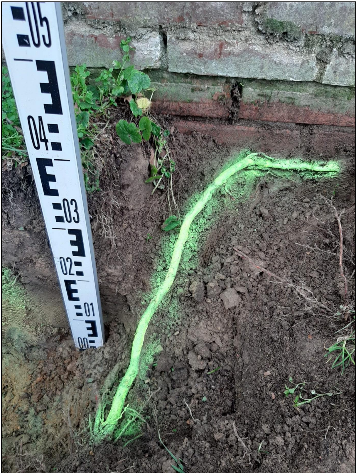
Figuur 14. Afbuigende wortel van boom 2 vanwege de muur op de erfgrans.
