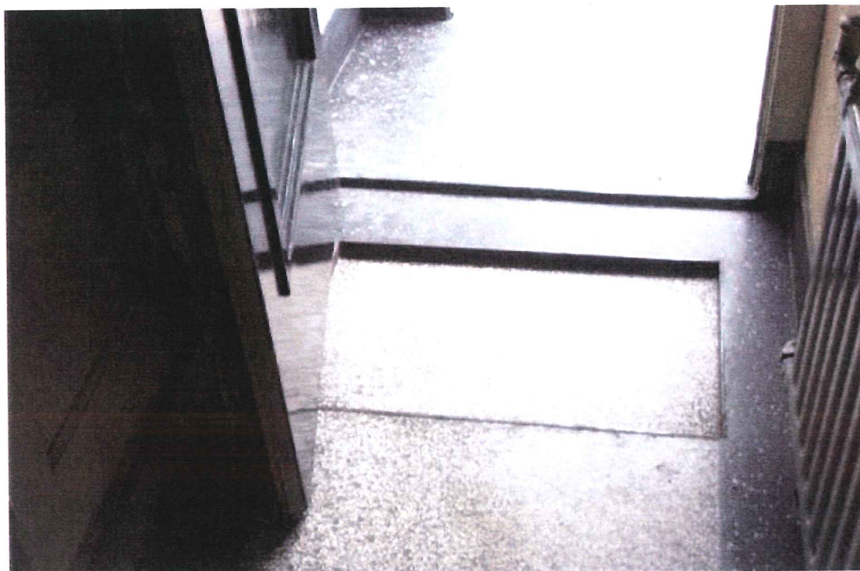
Afbeelding 61 Begane grond: dichtgezette sparing in vloer bij voordeur
