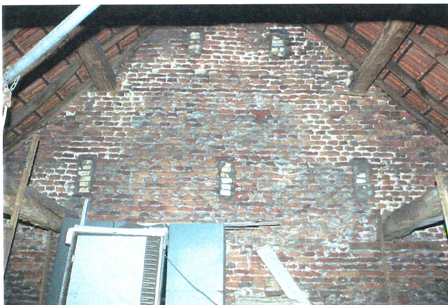
Afbeelding 159 Oostwand: houten balkjes (B) onder flieren (A) in het metselwerk en dichtgezette ventilatieopeningen (C)
