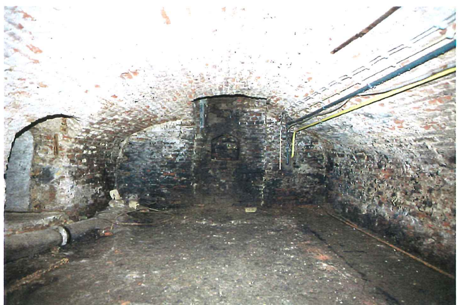
Afbeelding 18 Kelder: dichtgezette doorgang (A) aan straatzijde
