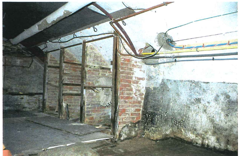
Afbeelding 40 Kelder nr. 18: sprong in metselwerk (A) tussen voorste en achterste deel kelder
