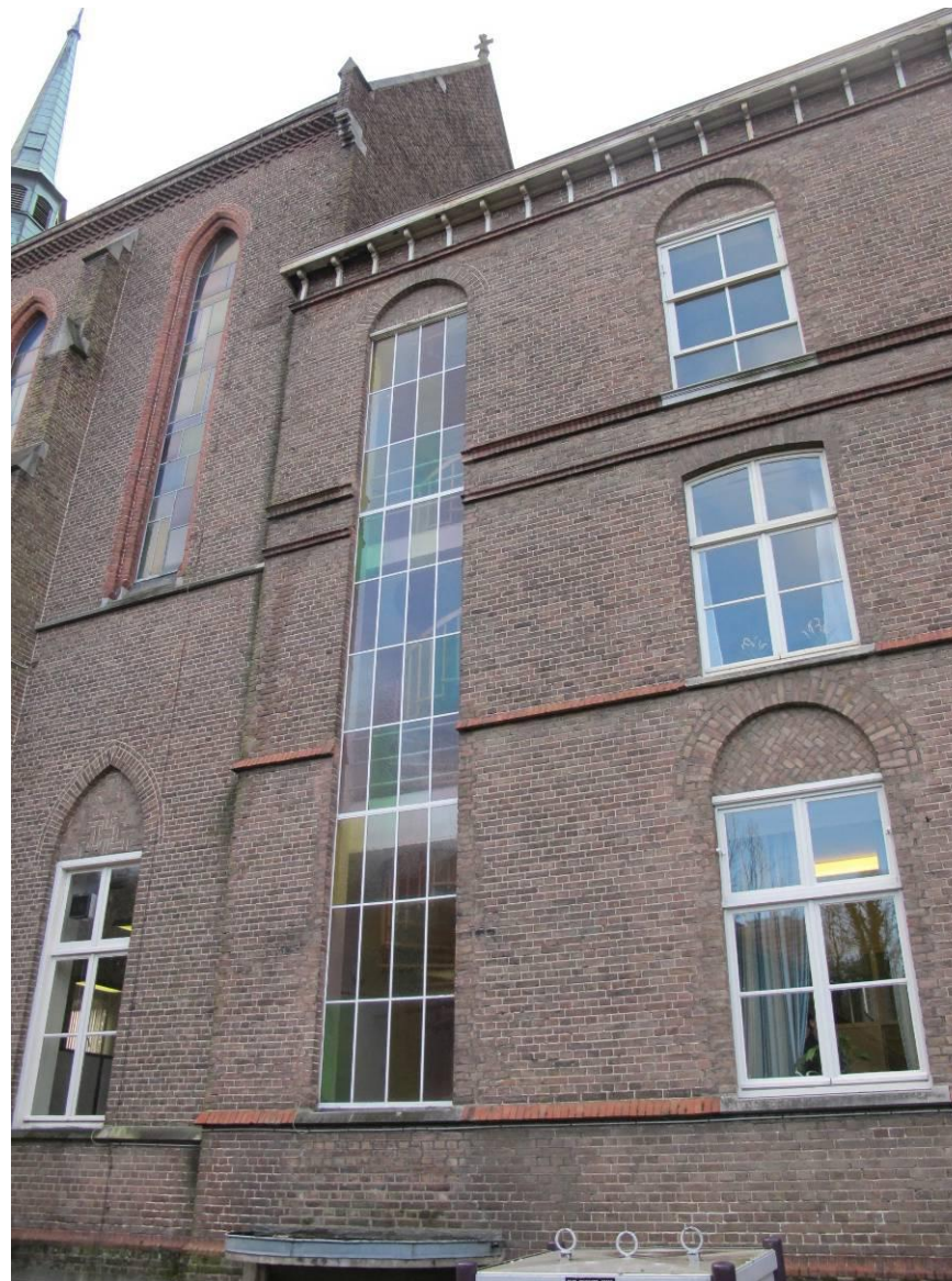
In 1963 ingebroken trappenhuisvenster in buitengevel rechter dwarsvleugel.
