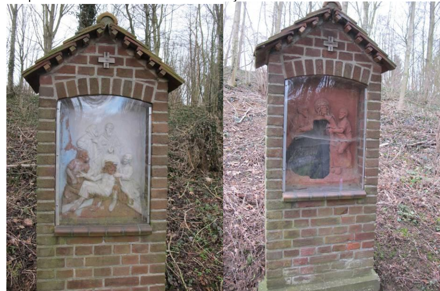
Twee andere staties van Watersley met schade door vandalisme.
