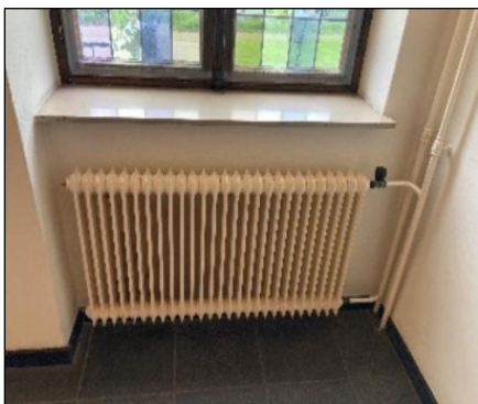
Foto: complicerende situatie bij binnenzijdige isolatie, ter plekke van gebouwdeel 1
