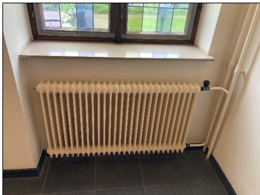
Bestaande radiator, zonder kraan om waterzijdig in te regelen
