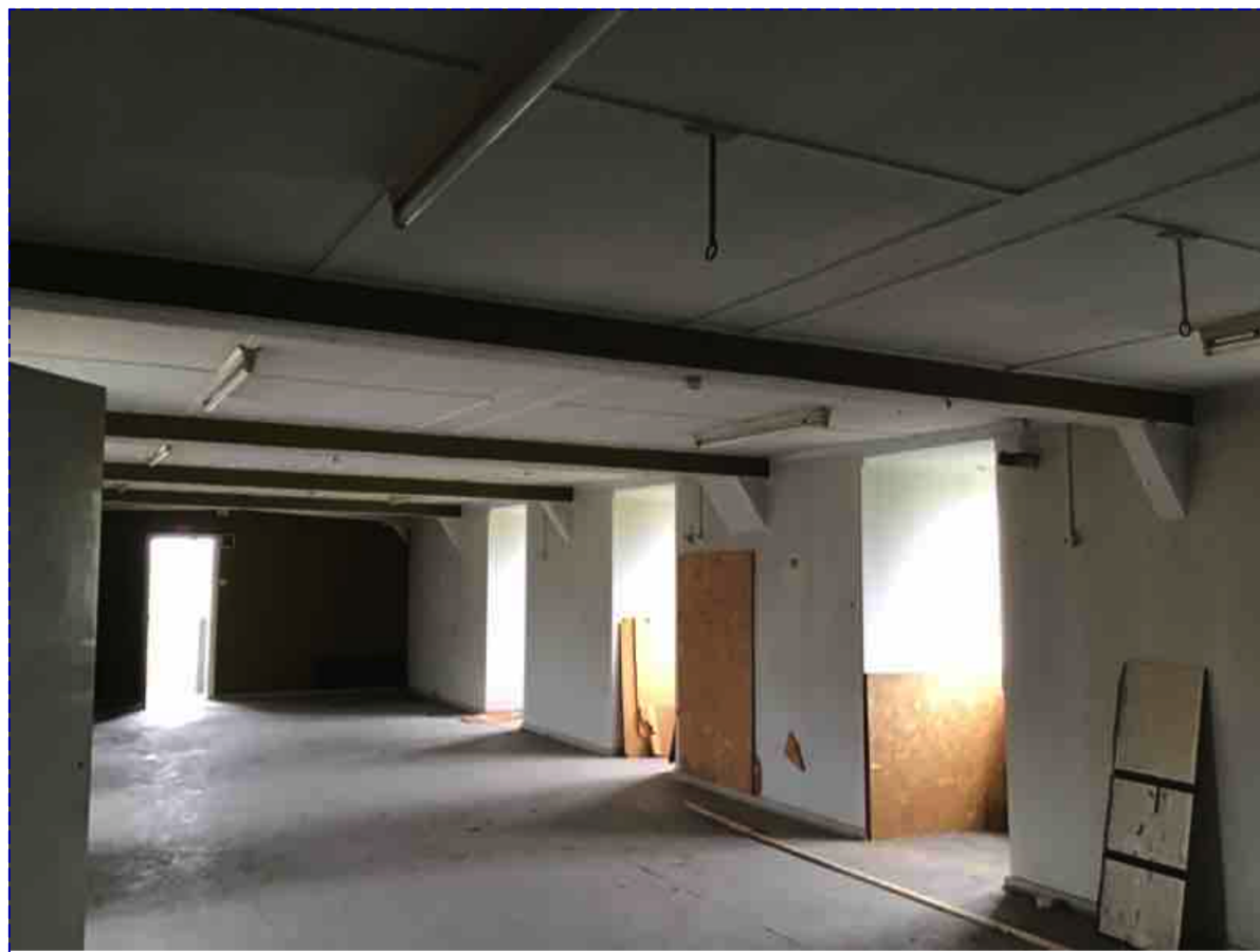
10. Gipswanden te verwijderen t.b.v. nieuwe invulling vleugel
