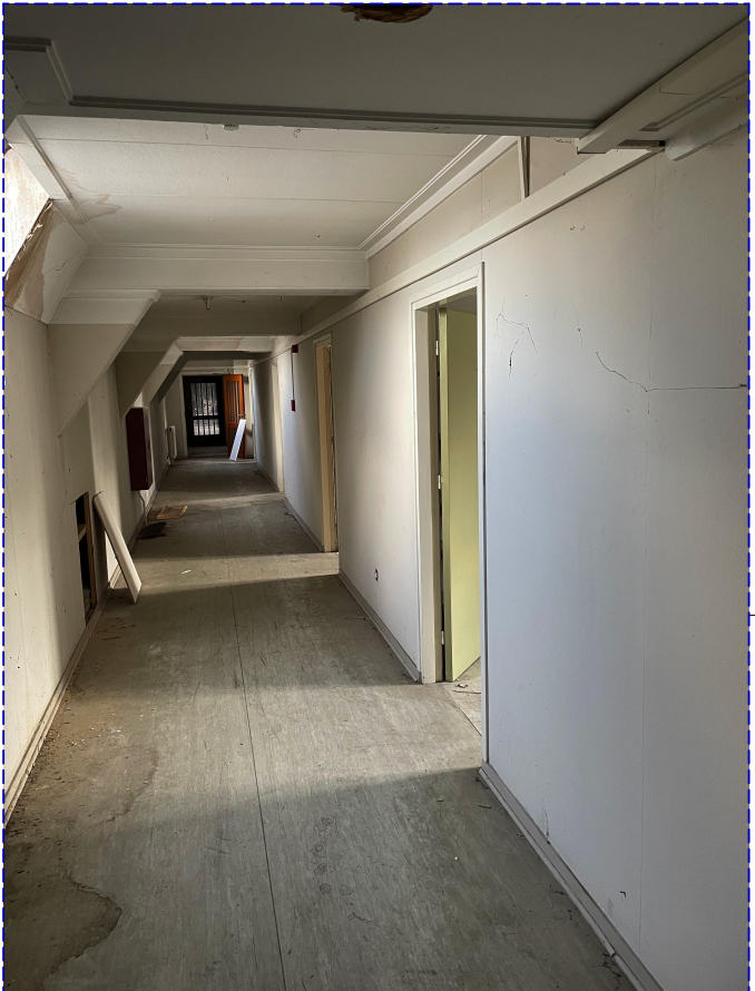
9. Gipswanden te verwijderen t.b.v. nieuwe invulling vleugel
