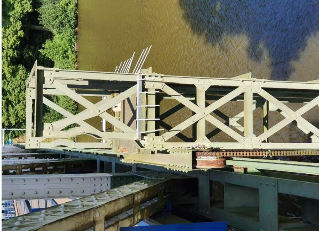
De verfwagen met bordes en bewegingswerk op de rails vanaf de brug gezien. FH MAB 2021
