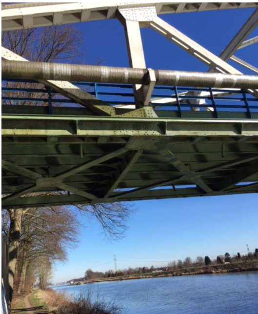
Afbeelding 1 Gasleiding en inspectiewagen
