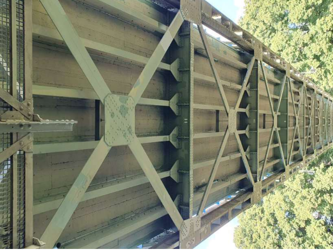
De onderzijde van de brug met dekconstructie en onderwindverband naar het westen gezien. In het vak tussen de dwarsdragers 9 en 10 en 10 en 11 zijn de langsdragers na de oorlog hersteld met platen. FH MAB 2021
