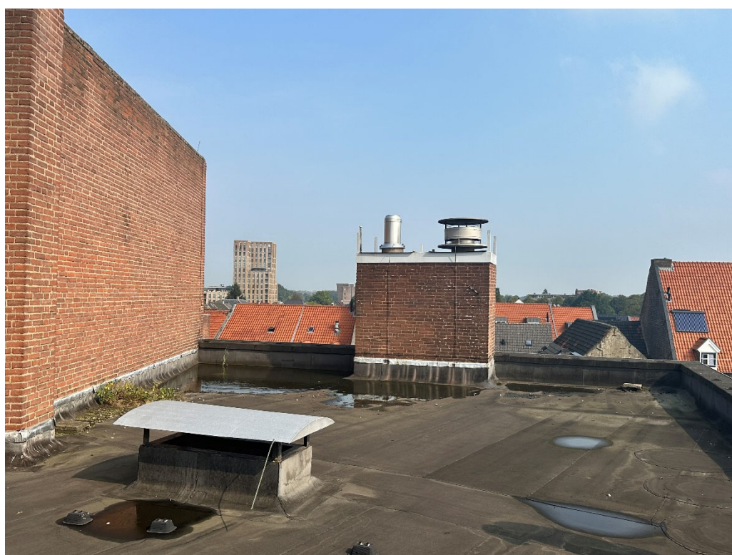
• Afbeelding 19: diverse opbouwen op het dat tbv installaties
