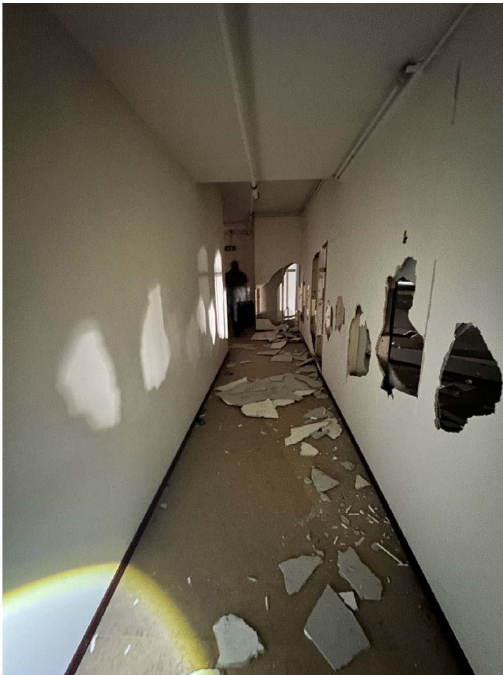
• Afbeelding 11: Binnenzijde, schade door vandalisme aan de metal studwanden
