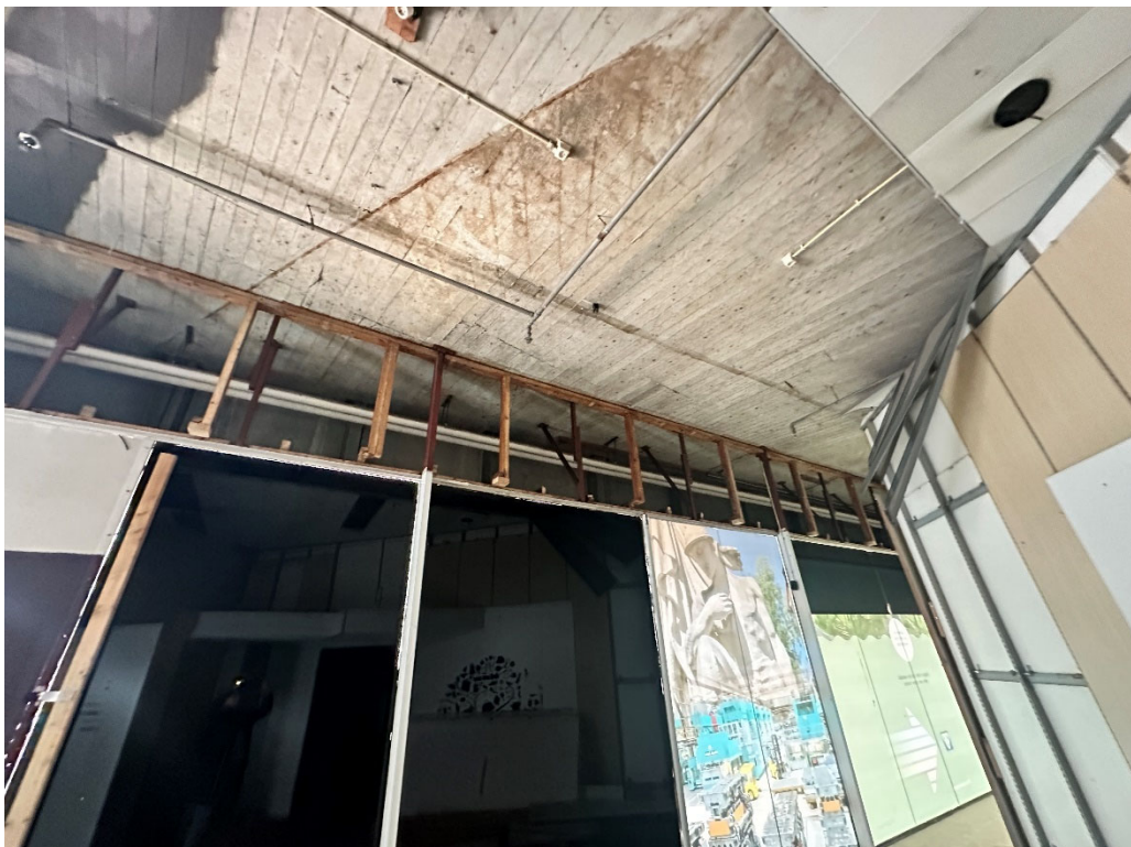
• Afbeelding 10: Binnenzijde gebouw, systeem plafond verwijderd, metal studwanden beschadigd
