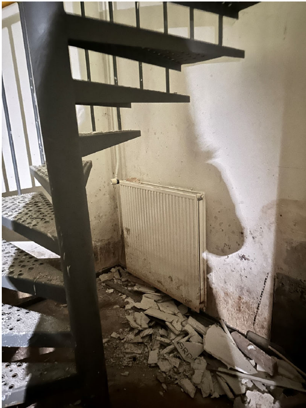
• Afbeelding 15: Trappenhuis noodtrap met schade als gevolg van vandalisme
