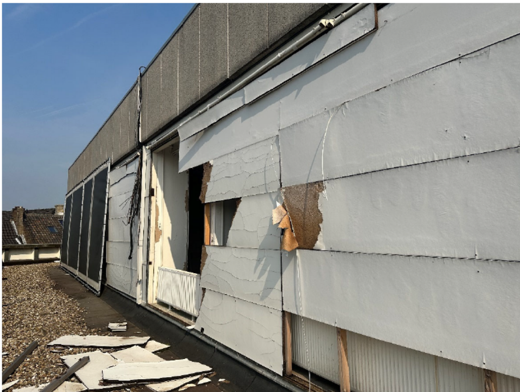
• Afbeelding 31: (beschadigde) gevel van terug liggend bouwdeel
