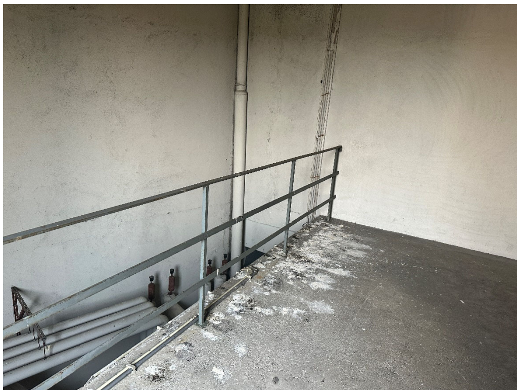
• Afbeelding 18: Binnenzijde ruimte voor mechanische ventilatie, sporen van een roofvogel
