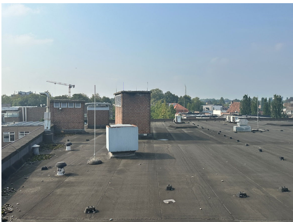
• Afbeelding 21: diverse opbouwen op het dat tbv installaties
