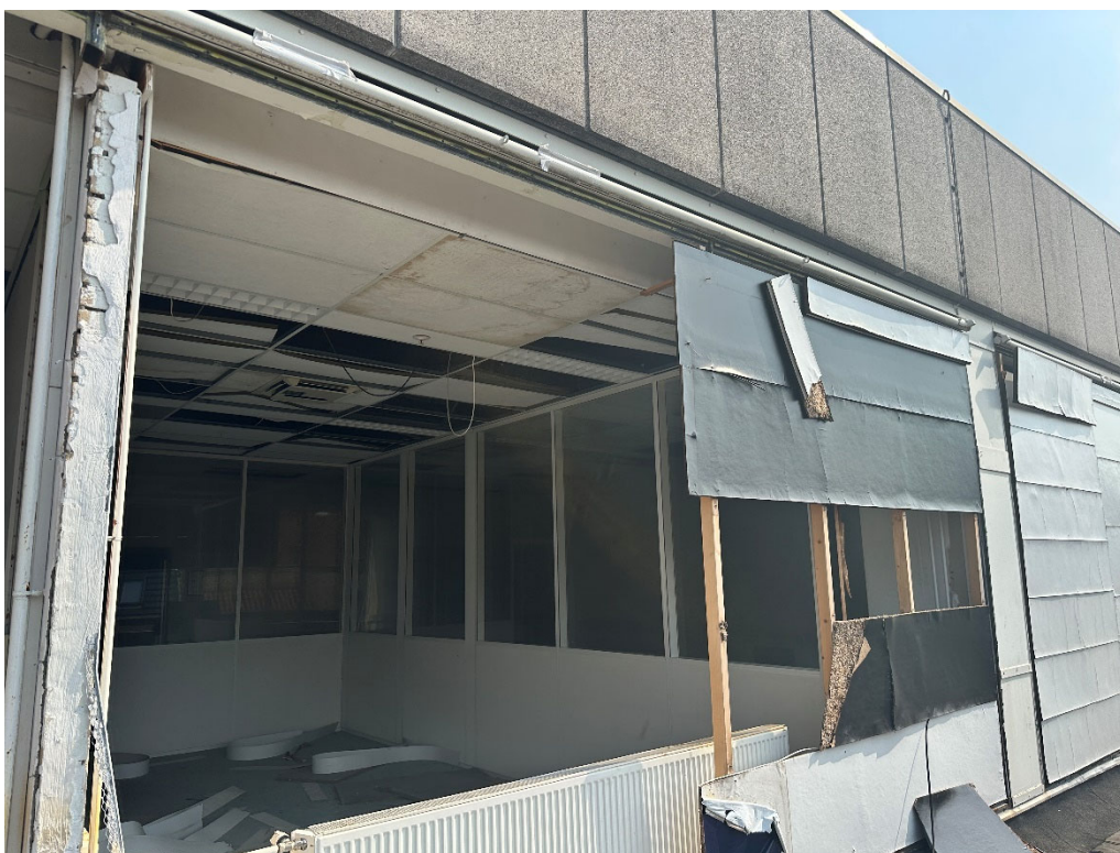
• Afbeelding 29: (beschadigde) gevel van terug liggend bouwdeel
