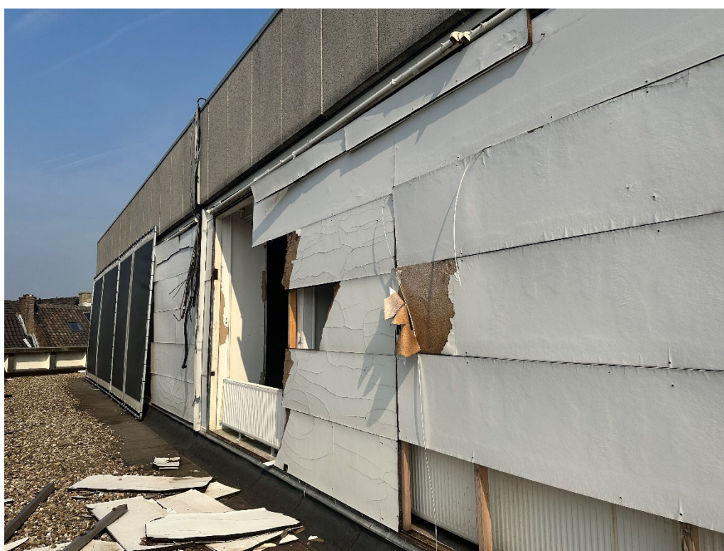
• Afbeelding 31: (beschadigde) gevel van terug liggend bouwdeel
