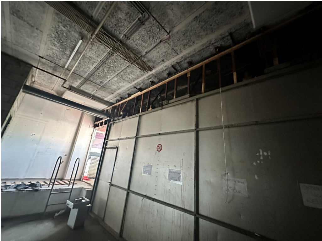
• Afbeelding 9: Binnenzijde gebouw, systeem plafond verwijderd, metal studwanden beschadigd
