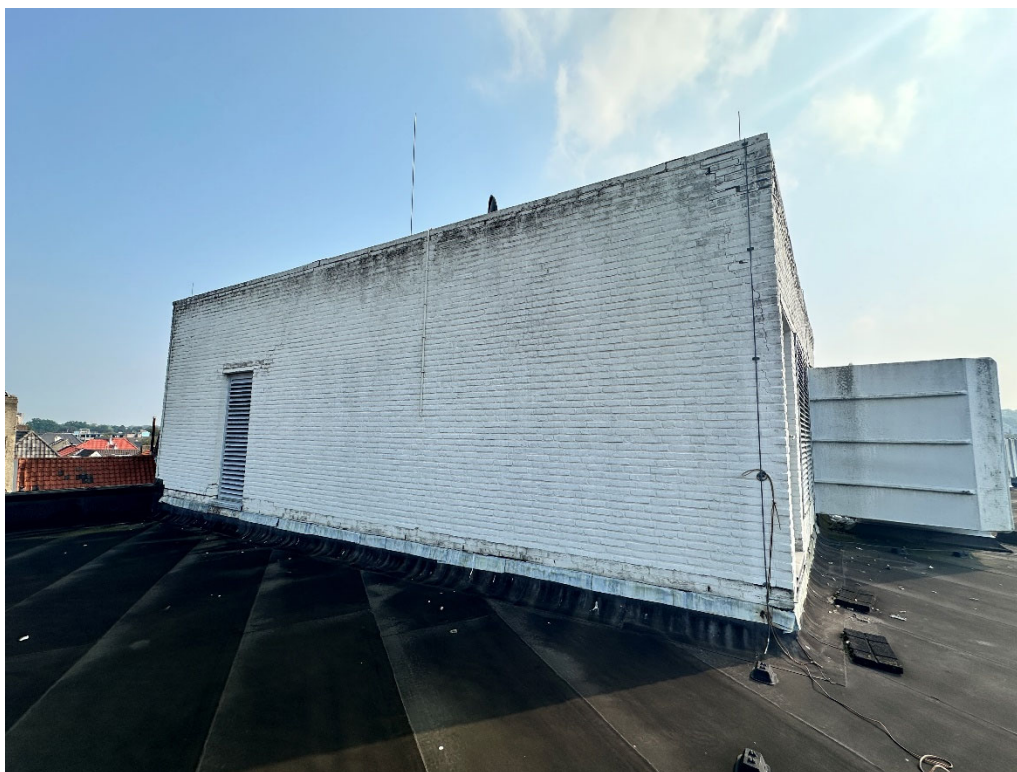
• Afbeelding 28: Dakopbouw mechanische installatie
