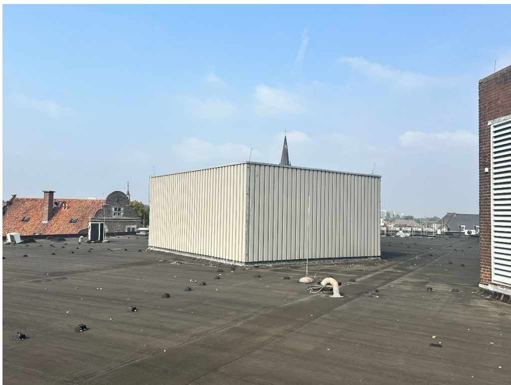
• Afbeelding 20: diverse opbouwen op het dat tbv installaties
