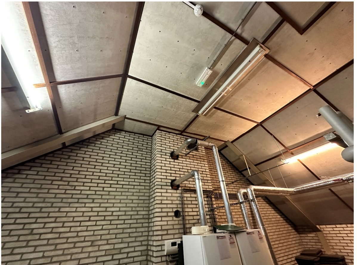
• Afbeelding 12: Onderzijde dak van het meest linkse, te slopen bouwdeel
