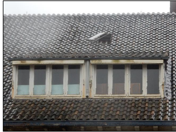
Figuur 16. Kapot dakraam, ruimte onder dakpannen en ruimte onder loodflappen waar vleermuizen makkelijk onder kunnen kruipen.
