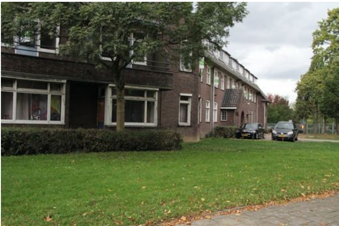
10. Foto van de knik in de voorgevel ter plaatse van de overgang van pensionaat naar klooster uit 2015 toen de ramen nog niet waren dichtgezet.
