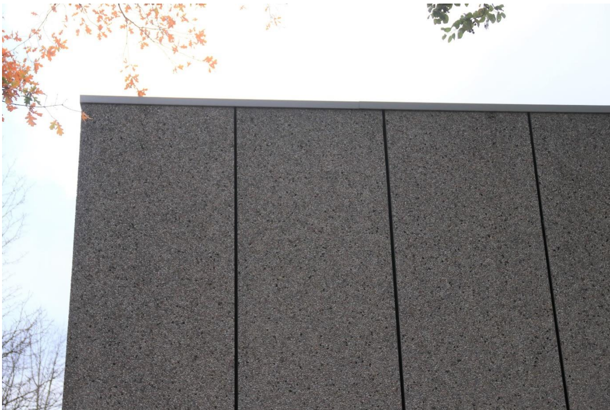
Foto 5: Op enkele plekken zijn openingen aanwezig tussen de gevelelementen (waar de achterliggende rubbers zijn weggezakt) en op een enkele plek is er ter plaatse van de metalen daktrim ruimte ontstaan die toegang biedt aan vleermuizen
