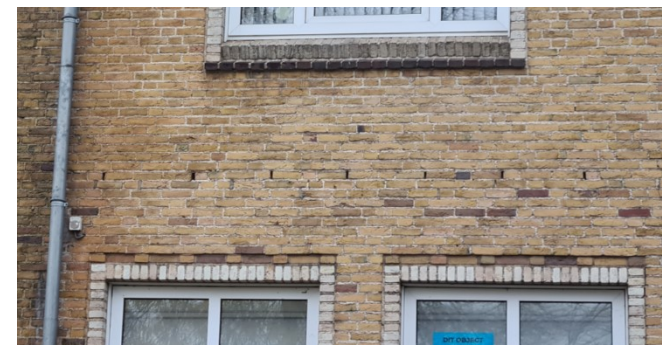
Figuur 13: Open stootvoegen in de noordgevel van Mauritspark 1A
