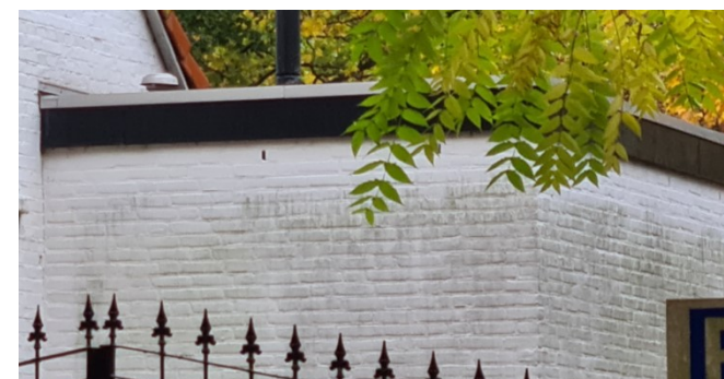
Figuur 15: Open stootvoegen in de uitbouw van Mauritspark 3
