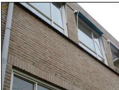
Figuur 11. Open stootvoegen in de buitengevel van het gebouwdeel aan de westzijde.
