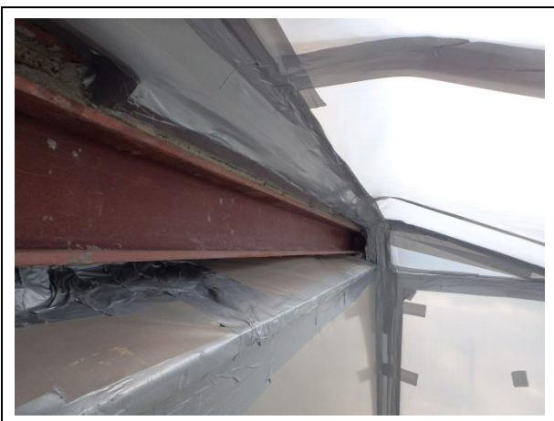
Foto 5: Verwijderde strook rechts
