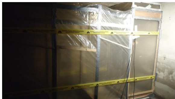
Foto 2: Keldercontainment met transitsluis.
