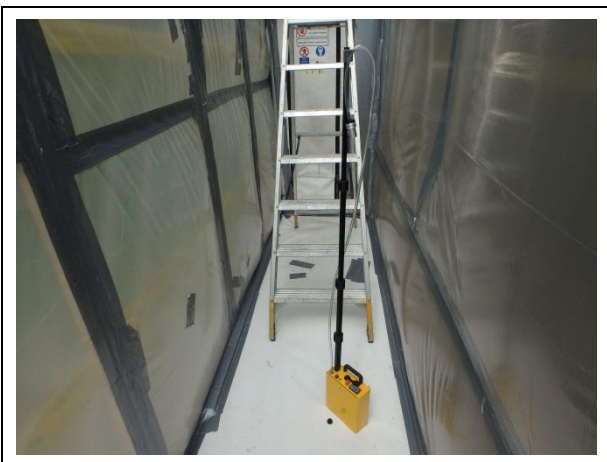
Foto 3: Overzicht containment binnen
