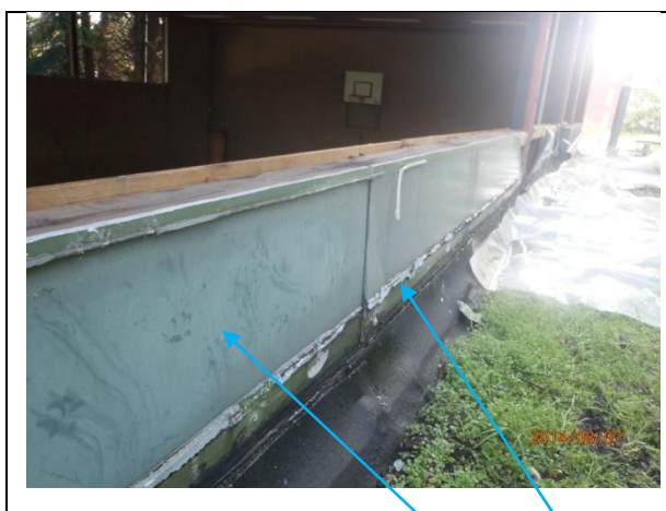
Foto 9: Asbestverdachte beplating en kit
