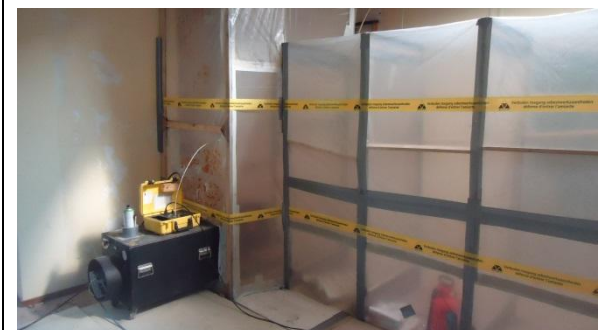
Foto 5: ODM en bg. Containment met transitsluis.
