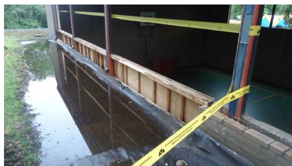
Foto 4: Deel van plat dak afgezet met lint.
