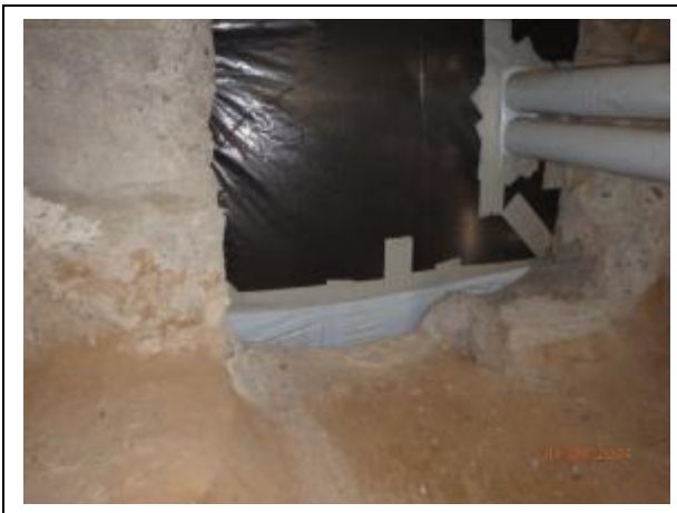
Foto 11: Keldermuur, bevestiging gesaneerd luchtkanaal
