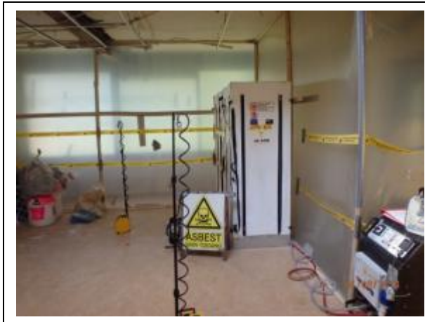
Foto 2: Vouddouche in lokaal 5 opgesteld
