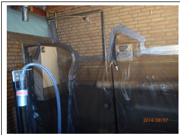
Foto 7: Verwarminginstallatie achter folie
