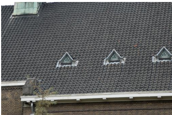
Foto 20: Vleermuisvoorzieningen in dak
