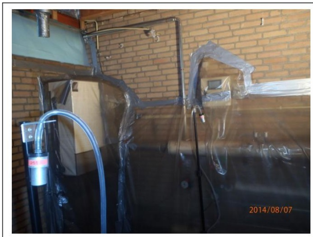
Foto 7: Verwarminginstallatie achter folie
