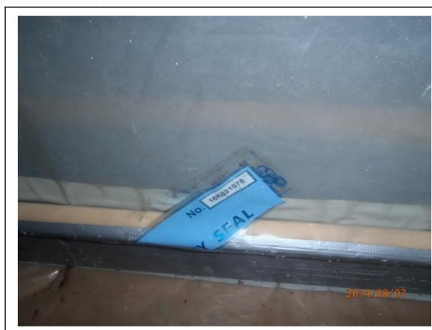
Foto 12: Containment verzegeld 16K021078
