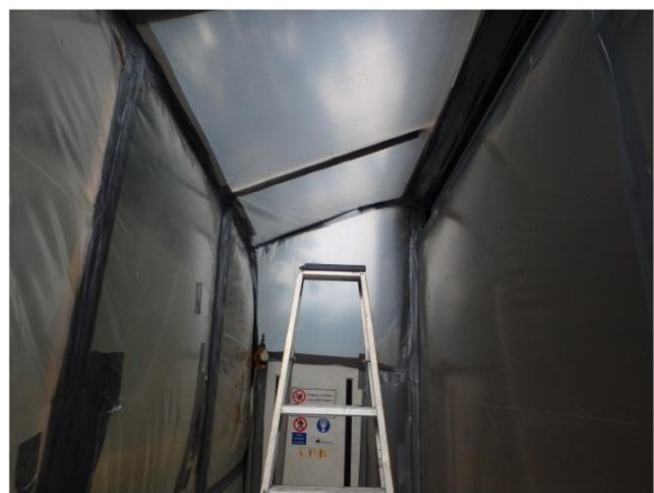
Foto 2: Overzicht containment binnen
