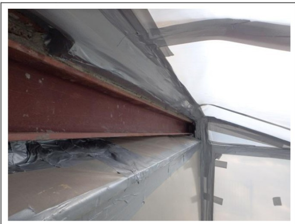
Foto 5: Verwijderde strook rechts
