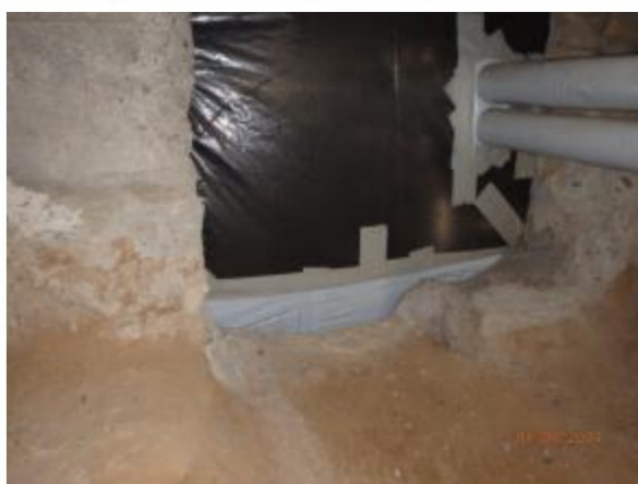
Foto 11: Keldermuur, bevestiging gesaneerd luchtkanaal
