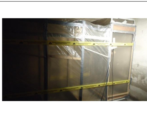
Foto 2: Keldercontainment met transitsluis.
