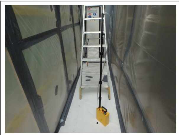
Foto 3: Overzicht containment binnen
