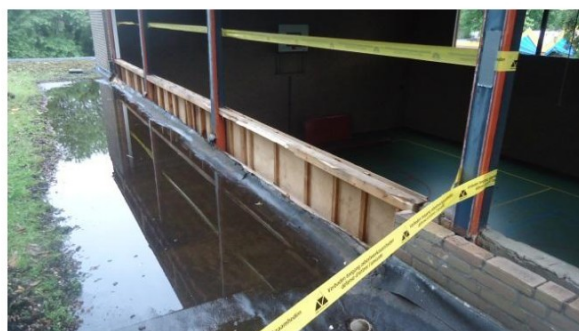
Foto 4: Deel van plat dak afgezet met lint.
