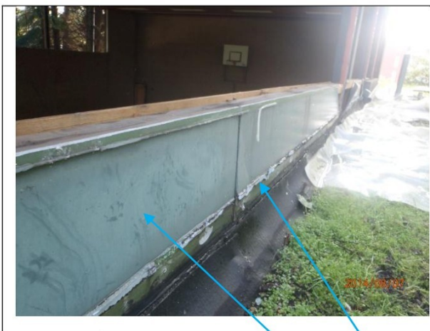
Foto 9: Asbestverdachte beplating en kit
