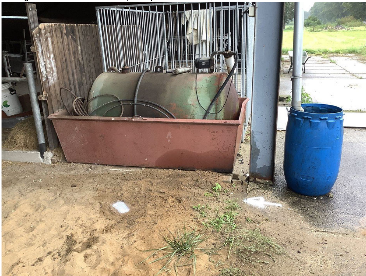
Bovengrondse dieseltank in lekbak, meetpunt 8
