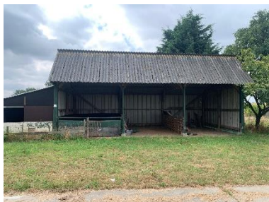
Foto 7 Schuur met asbestverdachte dakbedekking
