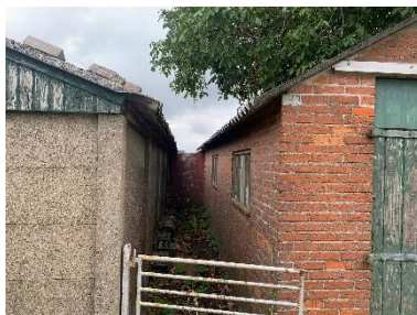
Foto 8 Schuren met asbestverdachte dakbedekking
