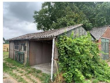
Foto 9 Schuur met dakgoten waarbij afwatering op het verharding plaatsvindt
