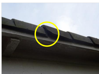
Figuur 5-2. Afgebroken kantpan.
