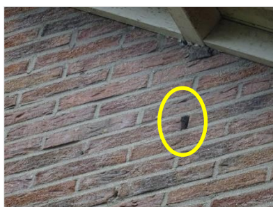
Figuur 5-5. Open stootvoeg kopgevel aan de westzijde.
