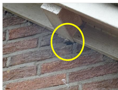
Figuur 5-7. Holte in de muur van de kopgevel aan de westzijde.
