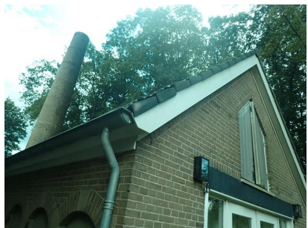
Foto 12: rechts, losse dakpannen en openingen bij dakrand voorkant stalgebouw.
