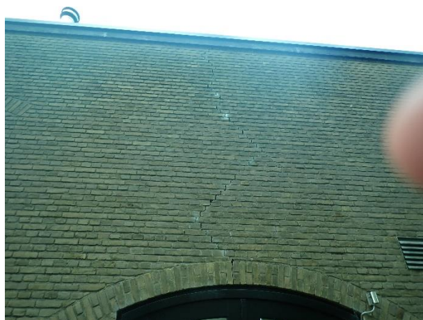
Foto 5: links, scheur in muur achterkant zuivelfabriek.
