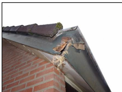
Figuur 14. Nestmateriaal in spleet dakgoot bungalow.
