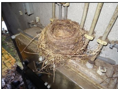
Figuur 24. Merelnest aangetroffen in aanbouw ligboxenstal.
