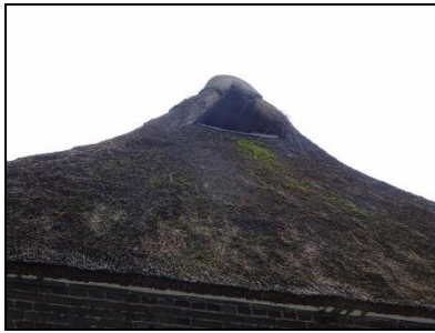
Figuur 32. Opening in dak boerderij.
