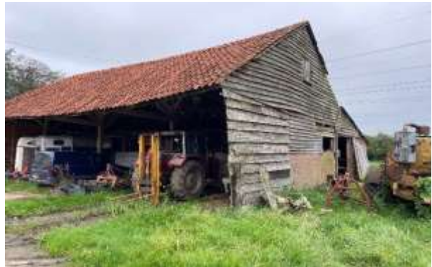
Figuur 14: Overzichtsfoto werktuigenopslag kapschuur
